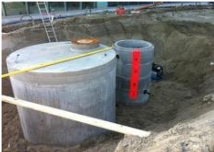
Figuur 13 Betonnen buffertank (fabiton, sd)
